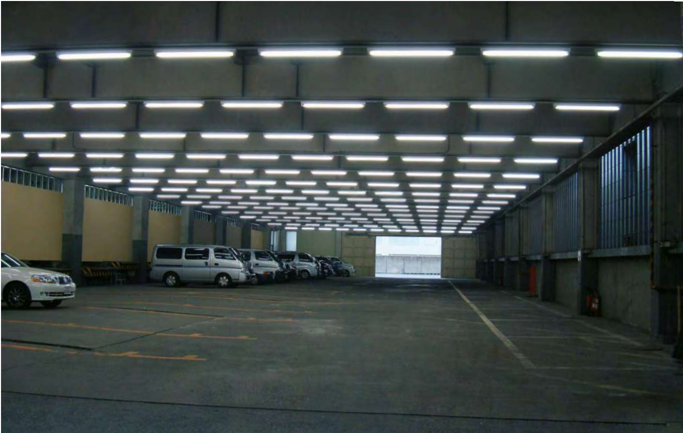
Luminarias industrialesde emergencia
